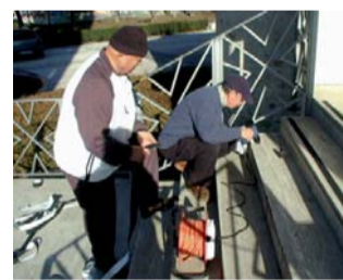
Nella foto, Marcello Coletti e Primo Lupattelli, operosi soci della "Pro Ponte", riversi sui gradini mentre applicano le strisce antisdrucchiolo.
