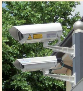
Telecamere di sicurezza
